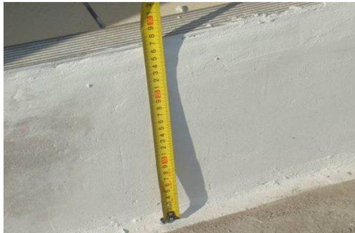
Рис. 6 – Перепад высоты между выходом и уровнем площадки крыльца
