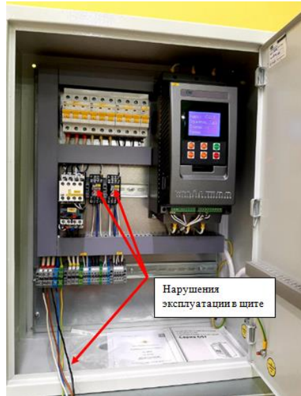
Рис. 1 – Неисправный щит управления системы противодымной вентиляции (подпора воздуха)
